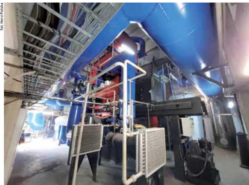
W skład kotłowni wchodzi również urządzenia towarzyszące: filtry i układy podawania paliwa oraz układ buforowy wody.
