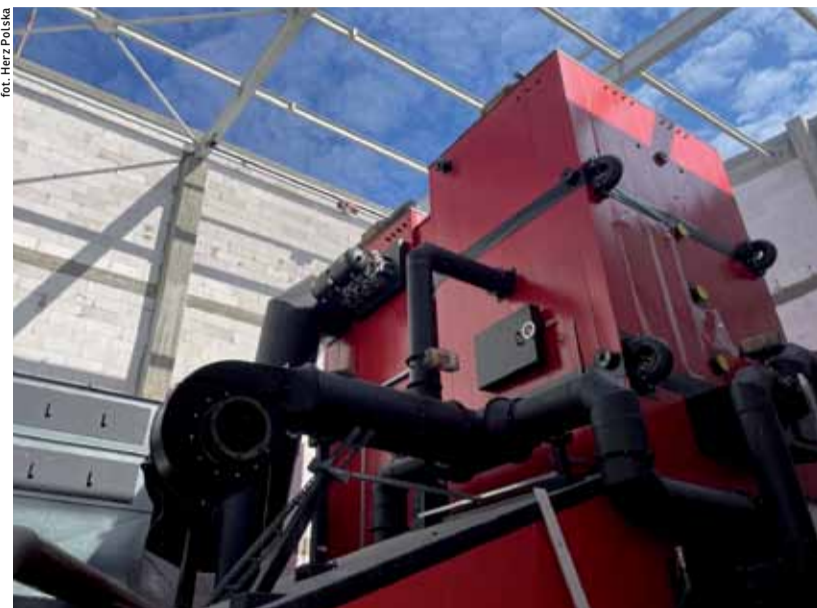
W firmie DANKROS zamontowano instalację z kotłem o mocy 6 MW termicznych.
