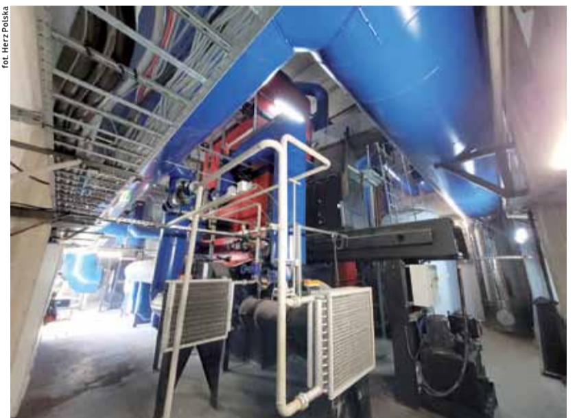
W skład kotłowni wchodzi również urządzenia towarzyszące: filtry i układy podawania paliwa oraz układ buforowy wody.
