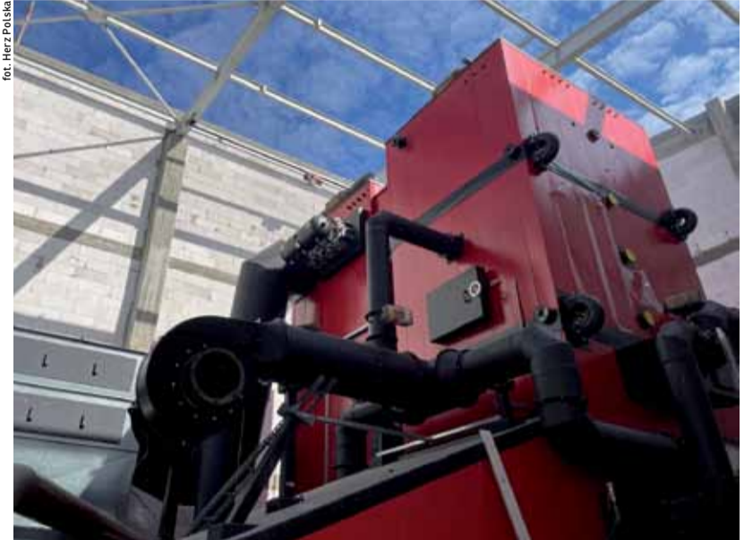
W firmie DANKROS zamontowano instalację z kotłem o mocy 6 MW termicznych.
